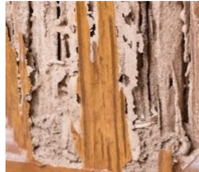
Kusen dalam kondisi tidak berfungsi menahan daun pintu/jendela
