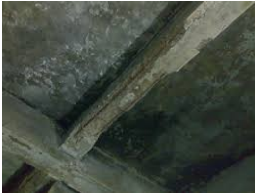
Balok melendut, selimut beton hancur, tulangan terlihat
