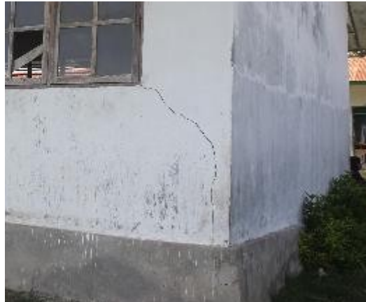
Plesteran kolom retak rambut
