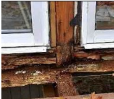
(kayu) terlihat lapuk / keropos dan berlubang pada sebagian besar kusen
