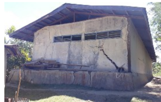
Pondasi patah, bergeser akibat longsor, struktur atas menjadi rusak
