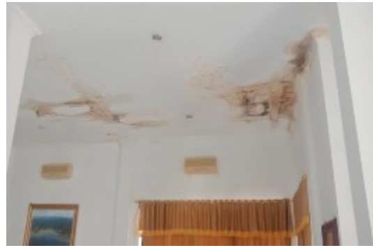
Terjadi indikasi kelembaban atau genangan air pada plafon meluas dengan bercak pada lapisan warna langit-langit meluas
