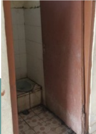
(kayu) terlihat lapuk / keropos dan berlubang pada bagian kecil pintu
