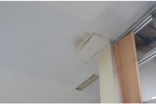
Indikasi kelembaban atau kebocoran kecil pada atap dengan adanya bercak pada sebagian lapisan warna langit-langit atau plafond
