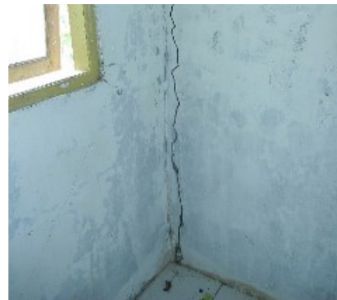
Retak pada permukaan kolom, lebar retak 0.2 mm- 1.0 mm
