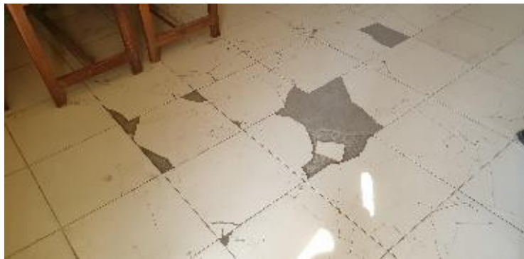
Penutup lantai retak atau remuk sebagian
