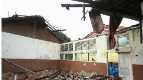
Penutup atap runtuh
