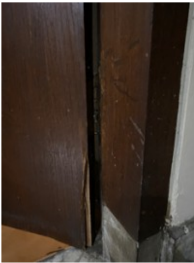
Perubahan warna pada sebagian lapisan warna finishing
