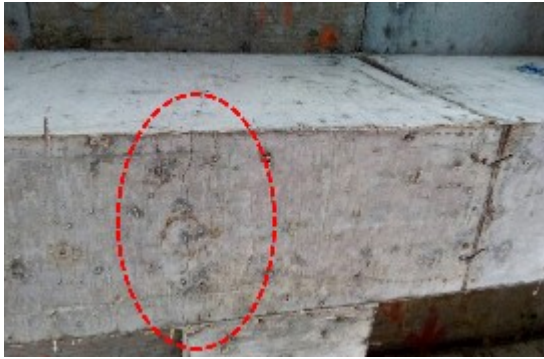
Plat lantai bergetar jika ada orang berjalan, retak rambut < 0.2 mm
