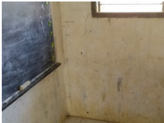
Retakan permukaan dinding terlihat jelas (lebar retakan kira-kira 0.2 mm- 1.0 mm)
