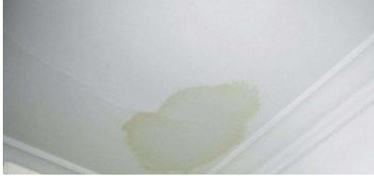
Perubahan warna pada sebagian lapisan warna finishing
