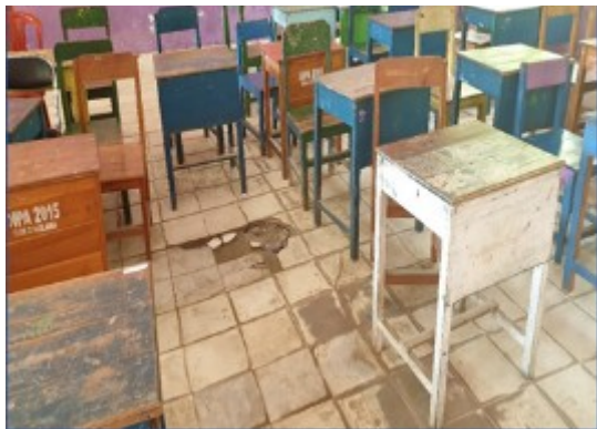
Penutup lantai terlepas sebagian,
