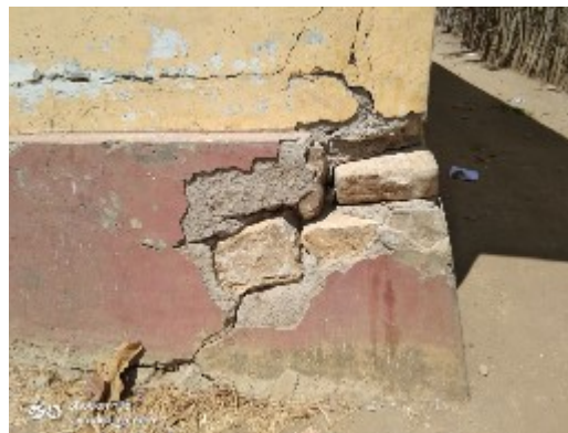
Penurunan tidak merata, namun perbedaan penurunan tidak melebihi 1/250 L
