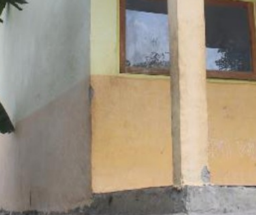
Sudut kolom pecah
