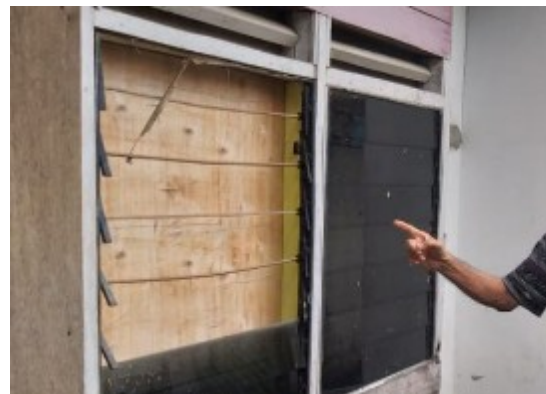
Penutup Kaca Retak Lebar/Pecah
