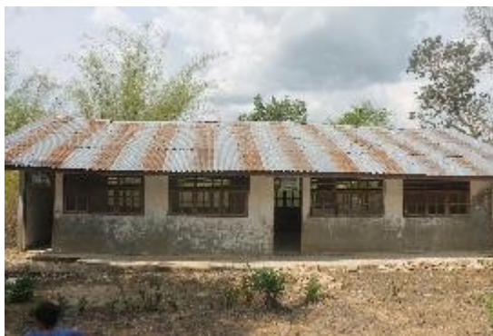
•Bangunan miring secara kasat mata Lantai dasar naik / menggelembung
