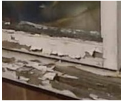
(kayu) terlihat lapuk / keropos pada sebagian kecil kusen
