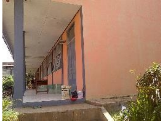
Perubahan warna pada cat dinding meluas
