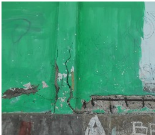
•Retak pada permukaan kolom, lebar retak > 1.0 mm Selimut beton gembur, beberapa tulangan terlihat
