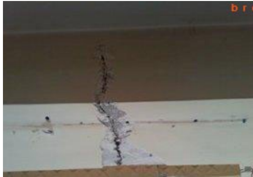
Retak 0.2 – 1.00 mm, retakan pada tengah bentang plat
