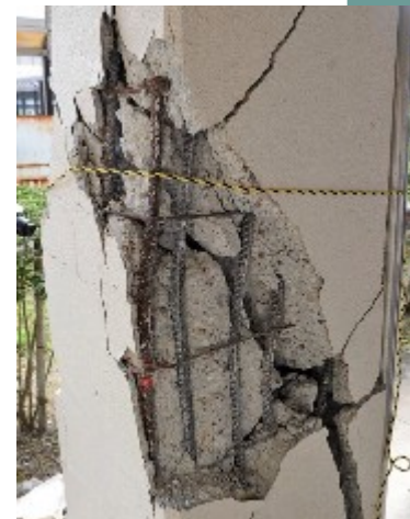
•Beton inti kolom hancur, baja tulangan tertekuk kolom patah
