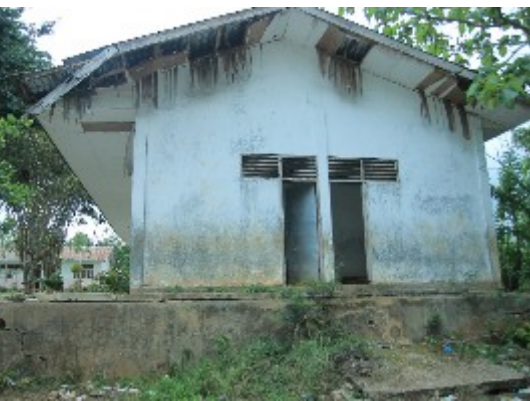
Penurunan merata pada seluruh struktur bangunan
