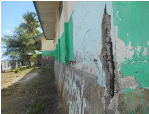
•Tulangan kolom terlihat 4 sisi pada 1 titik Selimut beton hancur pada beberapa titik
