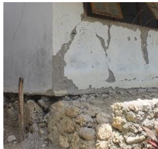
Penurunan > 1/250 L sehingga menimbulkan kerusakan struktur atasnya. Tanah disekeliling bangunan naik
