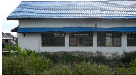
Penutup atap melendut sangat besar
