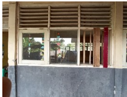
Daun Jendela Terlepas / Hilang/ Tidak sesuai persyaratan
