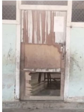
(kayu) terlihat rangka pintu patah / sambungan terlepas, multiplek penutup pintu terlepas/berlubang
