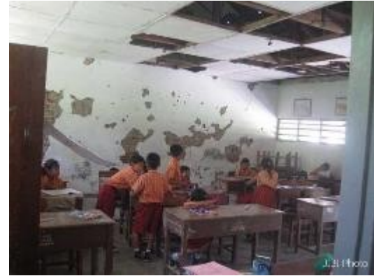
Plesteran rusak sebagian dan lapisan finishing lepas sebagian
