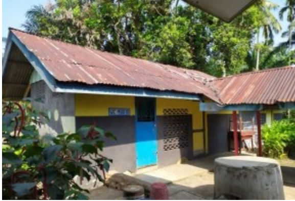
korosi meluas pada penutup atap
